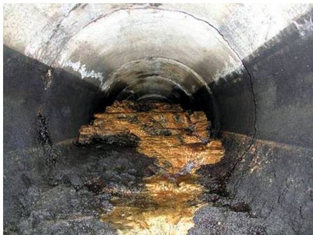
Рис. 3, а. Каскадный порог из железомарганцевых отложений, сформировавшийся в устьевом участке дренажного коллектора плотины № 3. Вид до выполнения очистки
