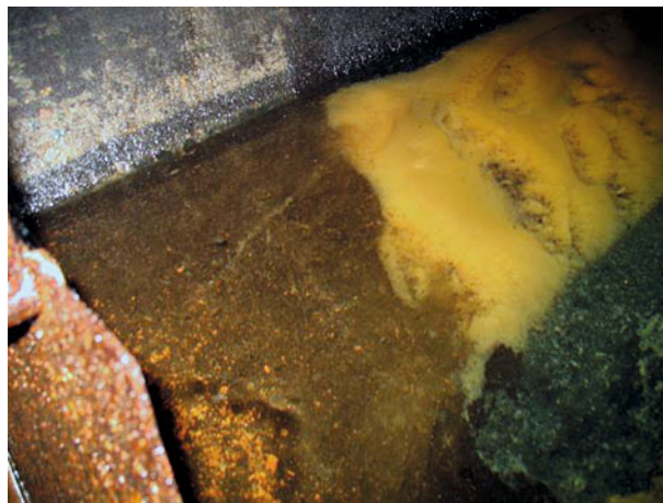
Рис. 3, е. При сбросе воды через водослив с тонкой стенкой в полости коллектора образуются взвешенные в воде охристые и скапливающиеся у нижней щельги трубы неконсолидированные марганцевые отложения
