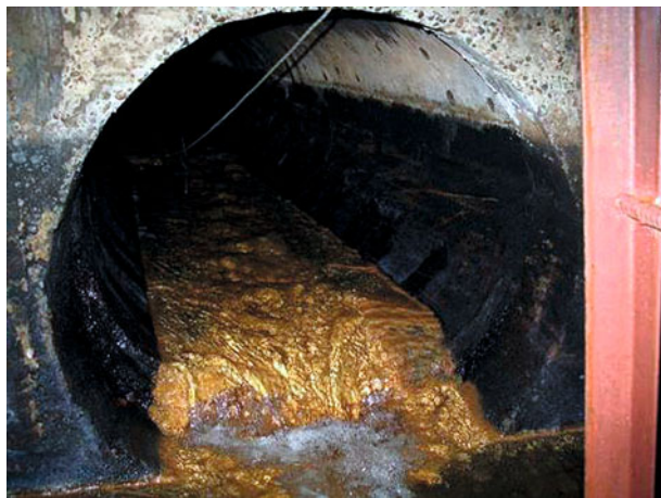
Рис. 3, в. При отсутствии водослива с тонкой стенкой в устье участка дренажного коллектора происходит образование первичного порога
