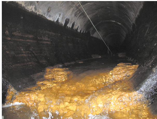
Рис. 3, г. При отсутствии мероприятий по очистке полости трубы на первичном пороге образуется следующий порог в виде каскада
