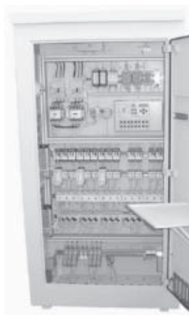
Рис.2 . Общий вид микропроцессорного шкафа ШУМТ-М
