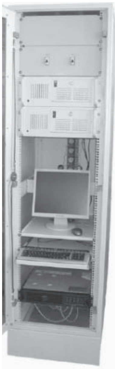
Рис. 3. Шкаф ШАРМ СУМ автоматизированного рабочего места
