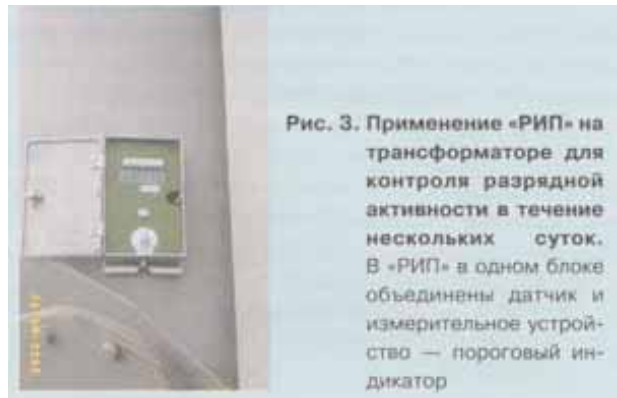
Рис. 3. Применение «РИП» на трансформаторе для контроля разрядной активности в течение нескольких суток. В «РИП» в одном блоке объединены датчик и измерительное устройство — пороговый индикатор
