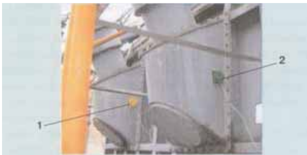
Рис. 2. Установка датчиков типа TMP-5 на карманы вводов ВН автотрансформатора. Датчики устанавливаются на три фазы: 1 — на фазу А, 2 — на фазу В
