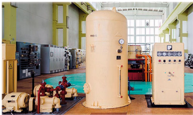
Рис. 1. МНУ и система управления в машинном зале ГЭС
